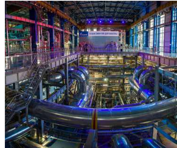
Парогазовой энергоблок мощностью 420 МВт на ТЭЦ-16 ОАО «Мосэнерго» Источник: ПАО «Газпром»
